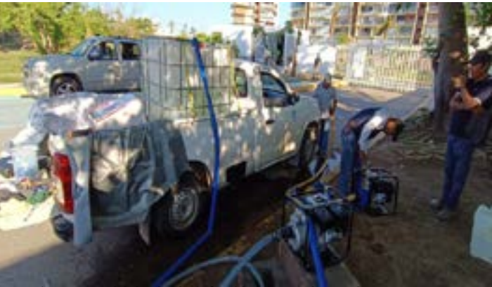
Figura 6. Módulo de desinfección operando en el pozo CEIBAAS
